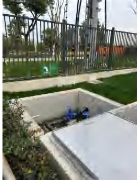
雨水总排口标识牌
