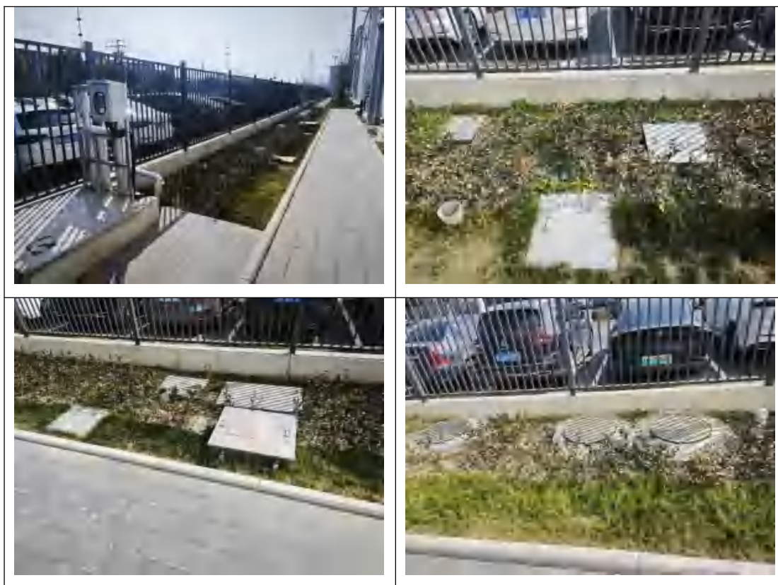
图 3-1 地埋式一体化污水处理设备
