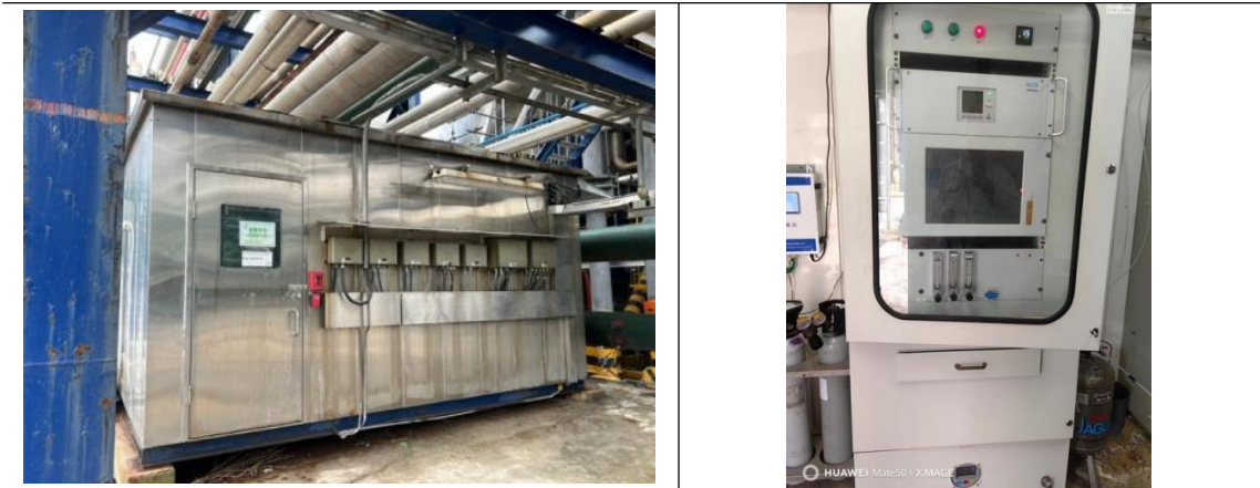
V 硫磺回收装置排口（DA045）在线监测小屋及在线监测设备
