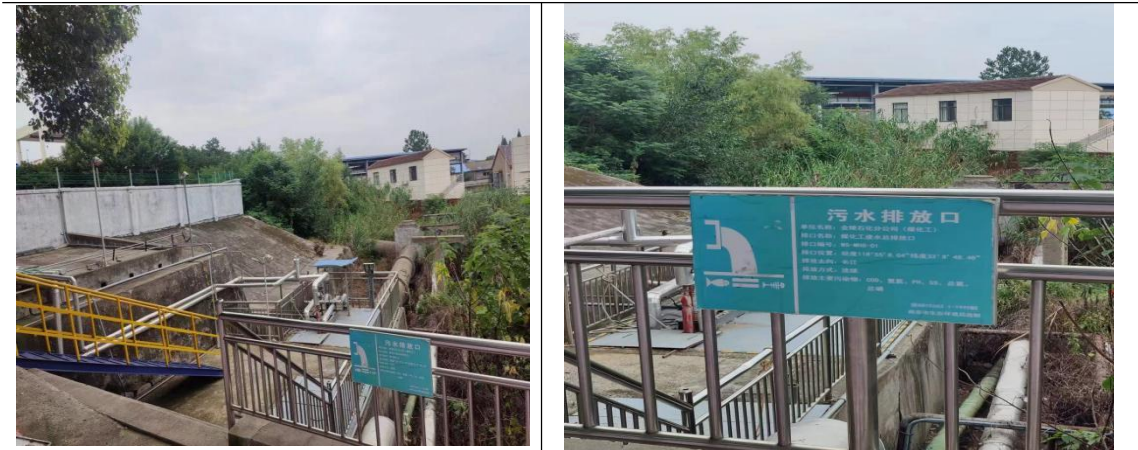
化工一部污水处理场排口及标识牌照片
