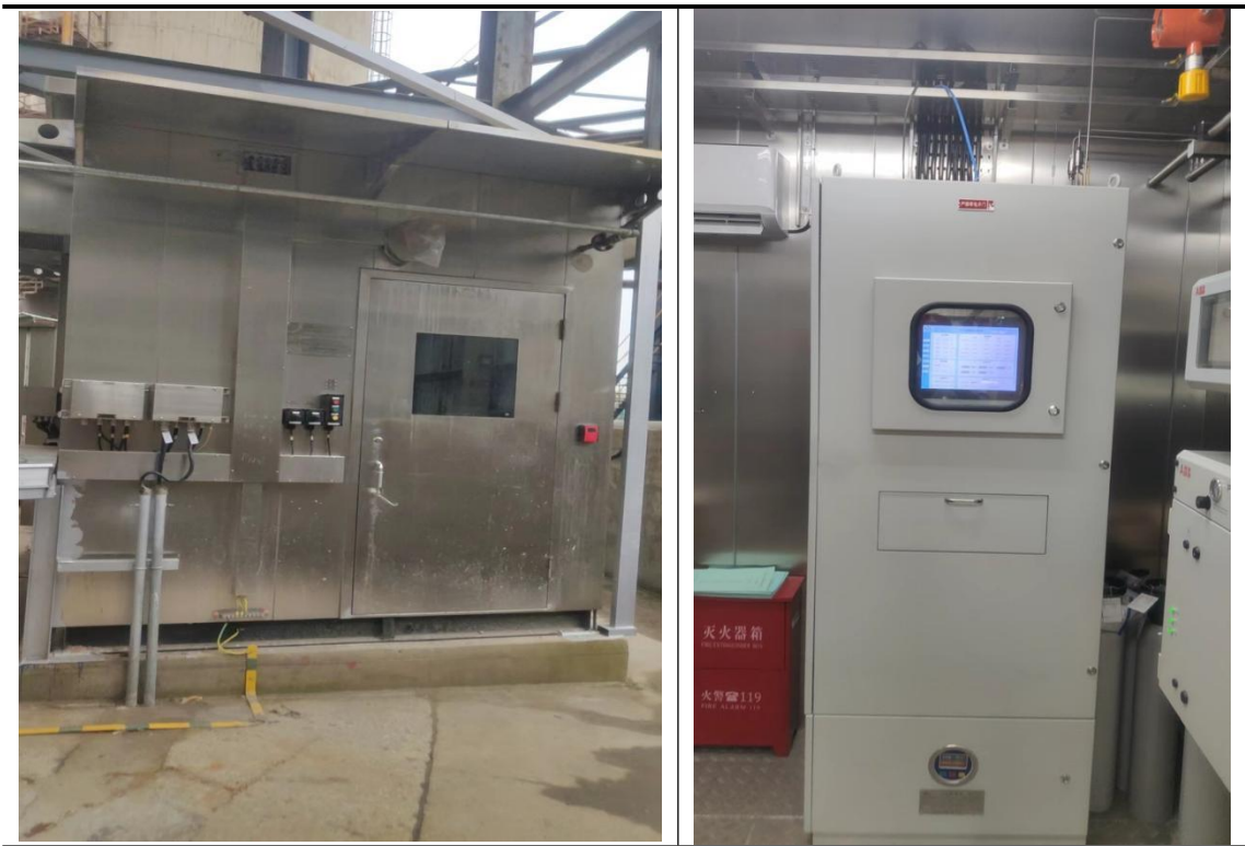
热电部 120m 烟囱（DA201）在线监测小屋及在线监测设备
