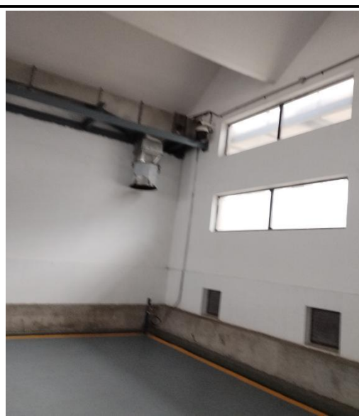
危废仓库内监控设备
