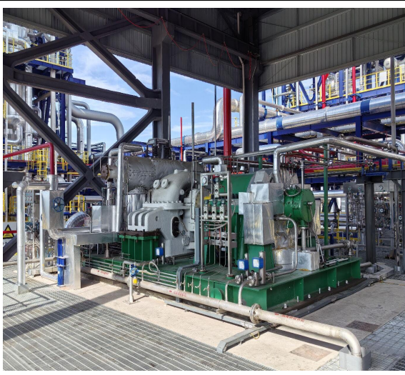
丙烯制冷装置
