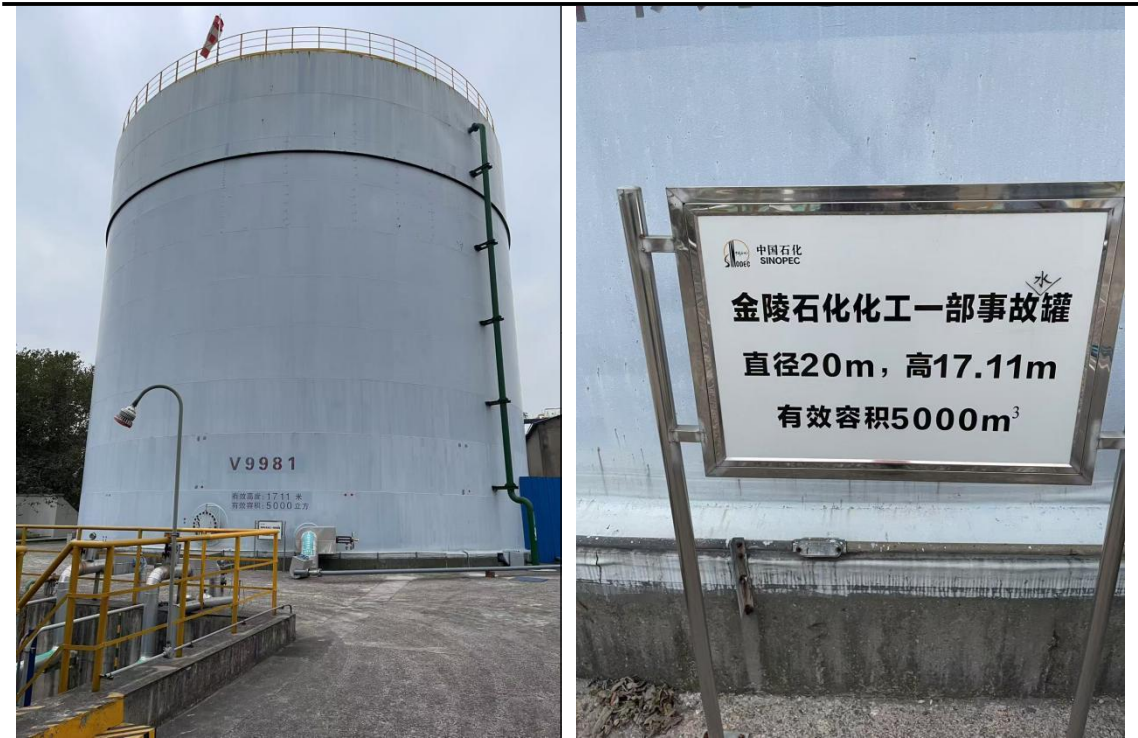
化工一部事故罐（5000m 3 ）
