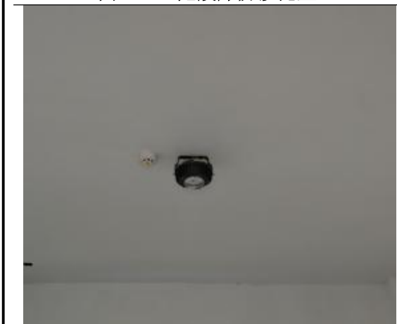
图 6-13 危废库防爆灯
