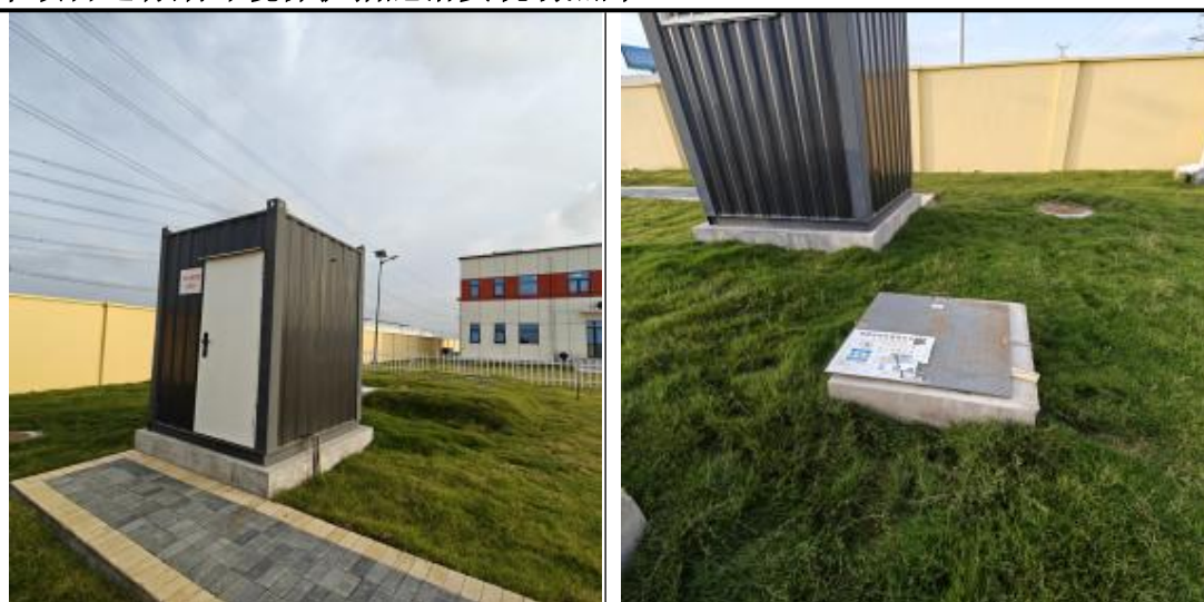
图 6-8 一体化生活污水处理设施控制室
