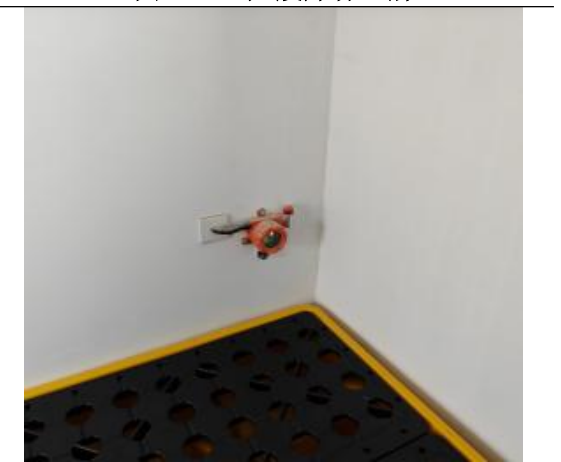
图 6-12 危废库可燃气体预警装置
