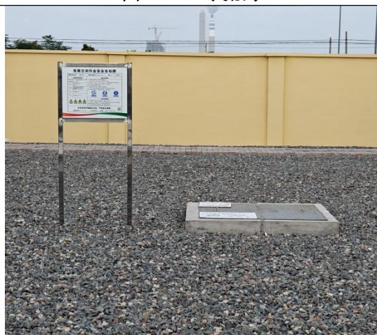
图 6-18 主变事故油池
