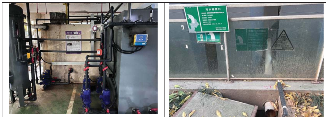
图 3-2 污水处理设施照片
