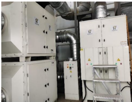
“初中效板式过滤器+静电吸附+UV光解+活性炭吸附”装置
