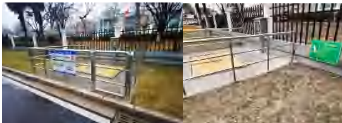
生活污水收集池及标识牌
