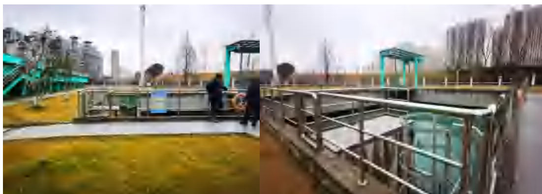
雨水泵井及池体照片
