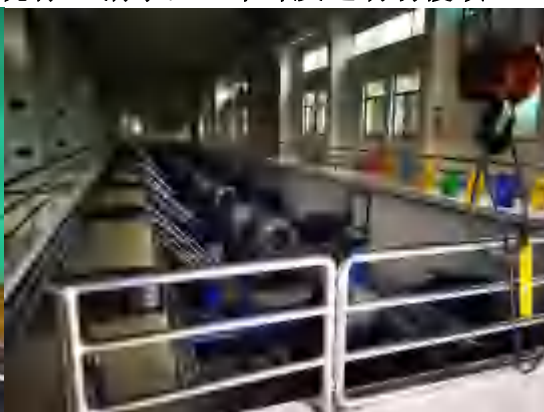
供水泵房内景
