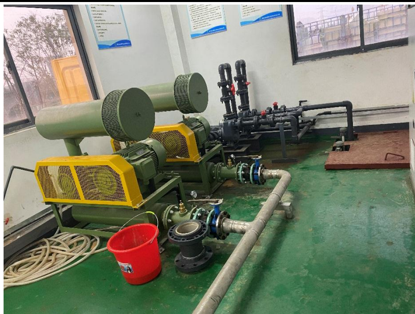
所在生命之光大楼污水处理设施
