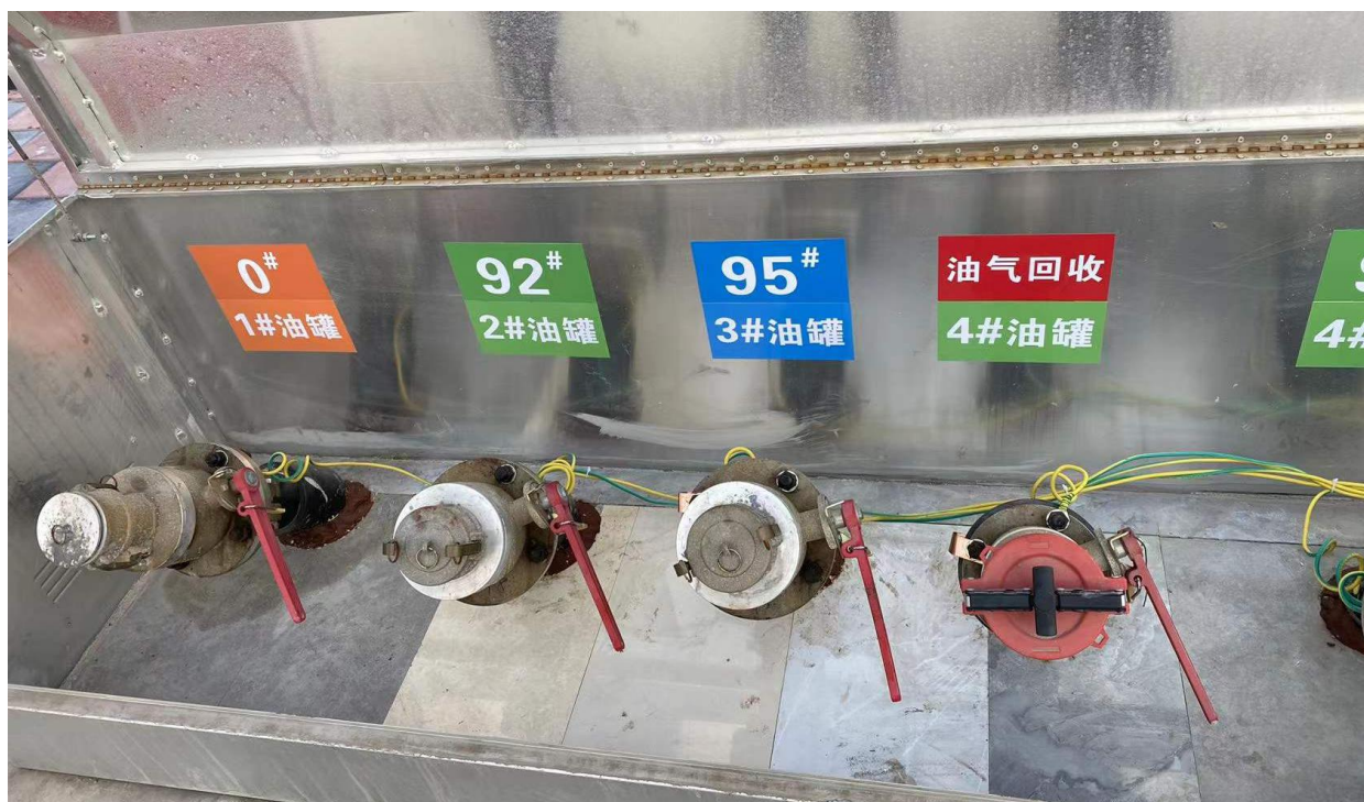
卸油口油气回收照片
